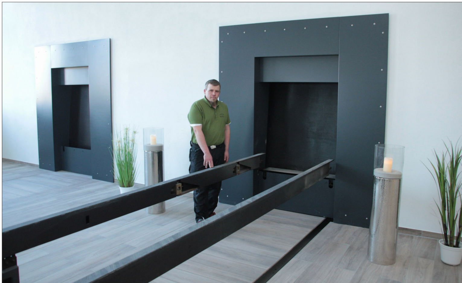
Kremationstechniker Christian Roßgoderer zeigt die Metall-Schienen, auf denen die Särge zur Einäscherung in den Ofen einfahren. Links davon ist schon alles vorbereitet für einen zweiten Ofen. Die Erweiterung ist in drei Jahren geplant.
